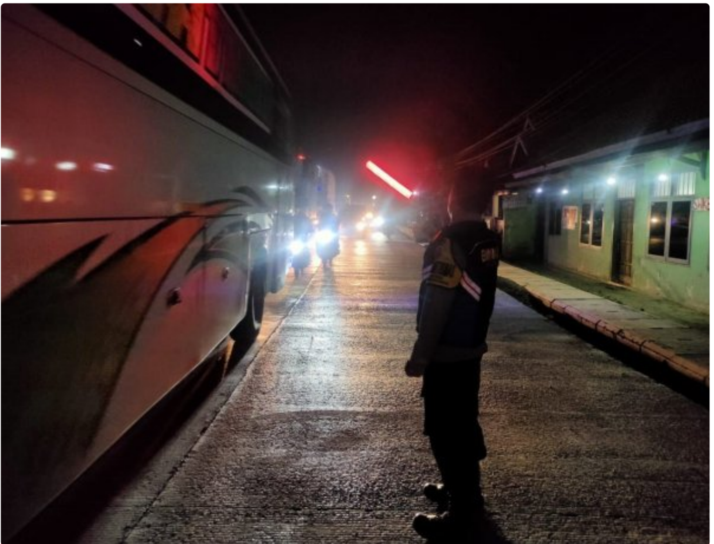
Giat Pelayanan Masyarakat: Polsek Losarang Gatur Lalu Lintas di Penyempitan Jalan Pengecoran di Desa Jangga dan Desa Jumbleng
